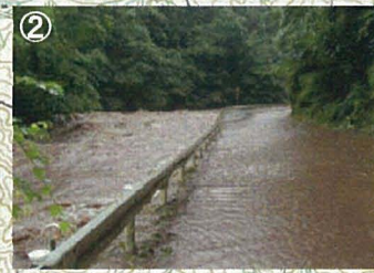
② 現道(路面冠水)
