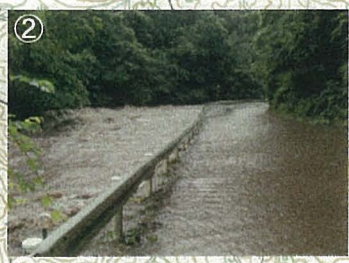
② 現道(路面冠水)
